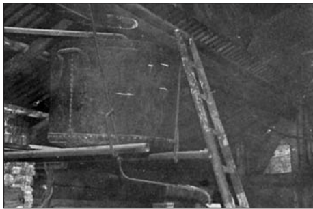
Réservoir suspendu, d'une contenance de 250 litres.
